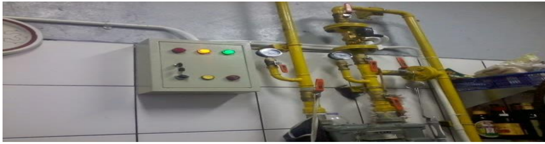
Instalasi Gas & System pengamannya
